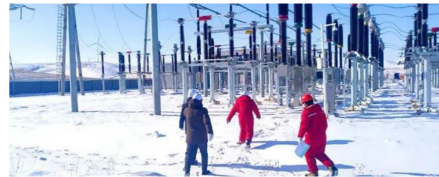
丰宁大区风电场升压站设备巡视
